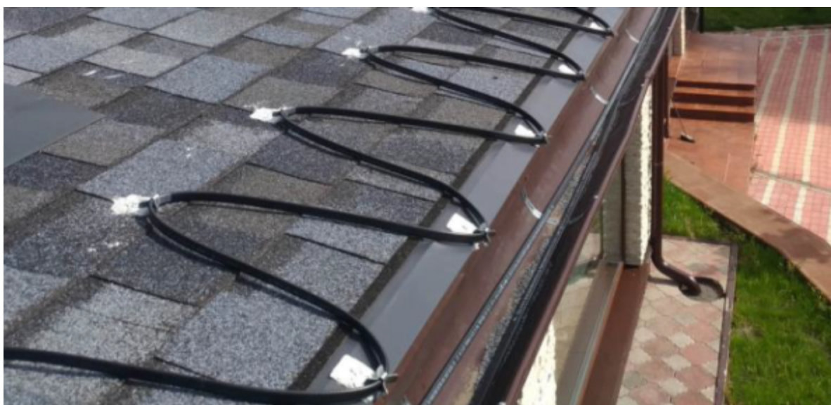
Проблемный участок крыши. Кровля - катепал.
