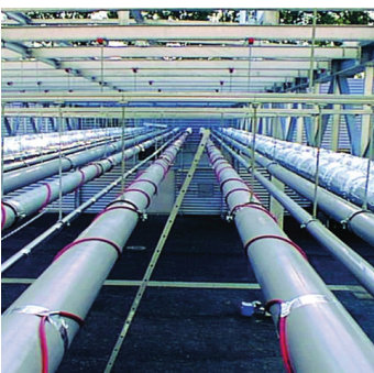
Защита трубопроводов от замерзания
